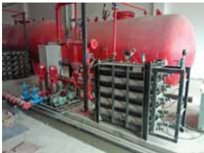
国内最大民用飞机总装制造基地使用的D--QD气体顶压设备
